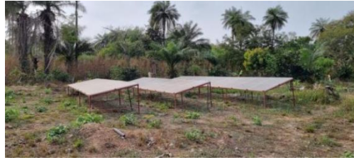
Zonnepanelen voor aandrijving machines
